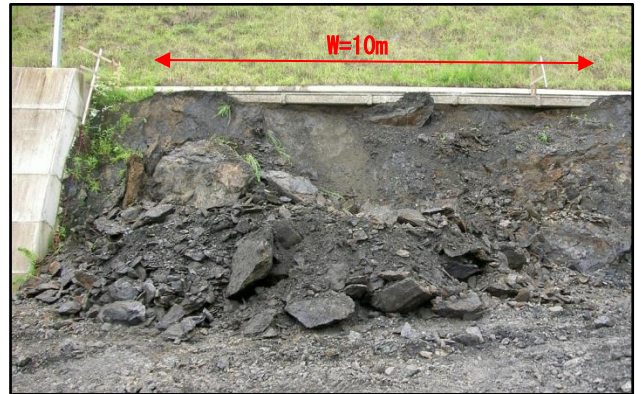
写真-2 B地区変状状況
