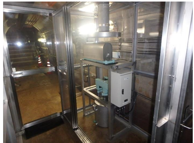
写真-2 ノーマルプラムライン装置のうち 監査廊内のたわみ検出装置
